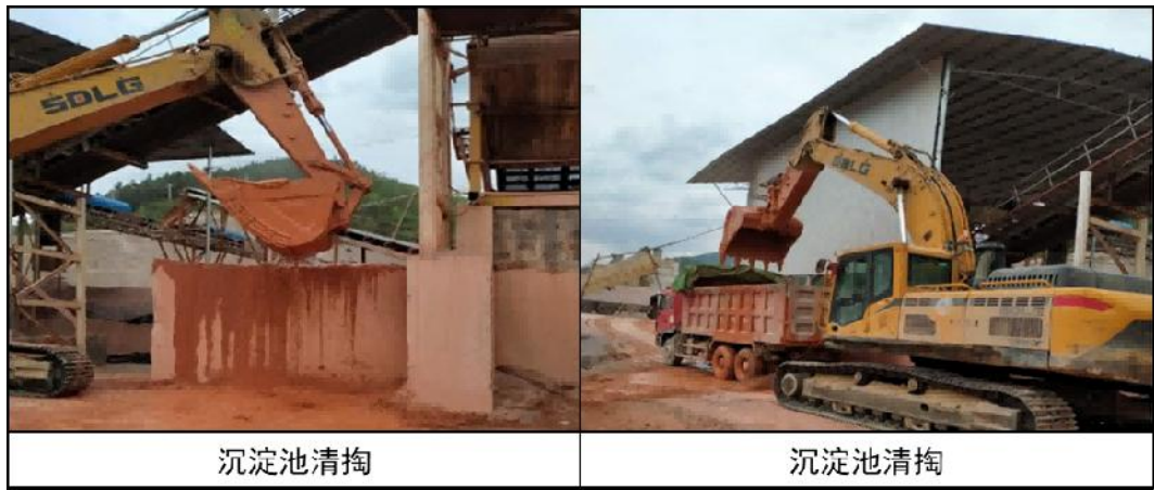
图 4.2-17 混凝土系统废水处理措施现场照片
