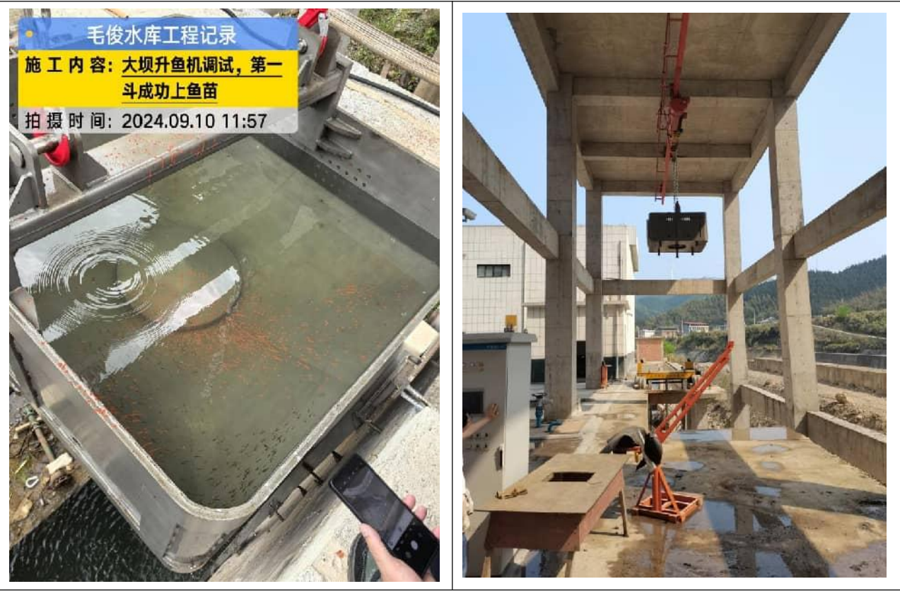
图 4.2-6 升鱼机运行现场照片
