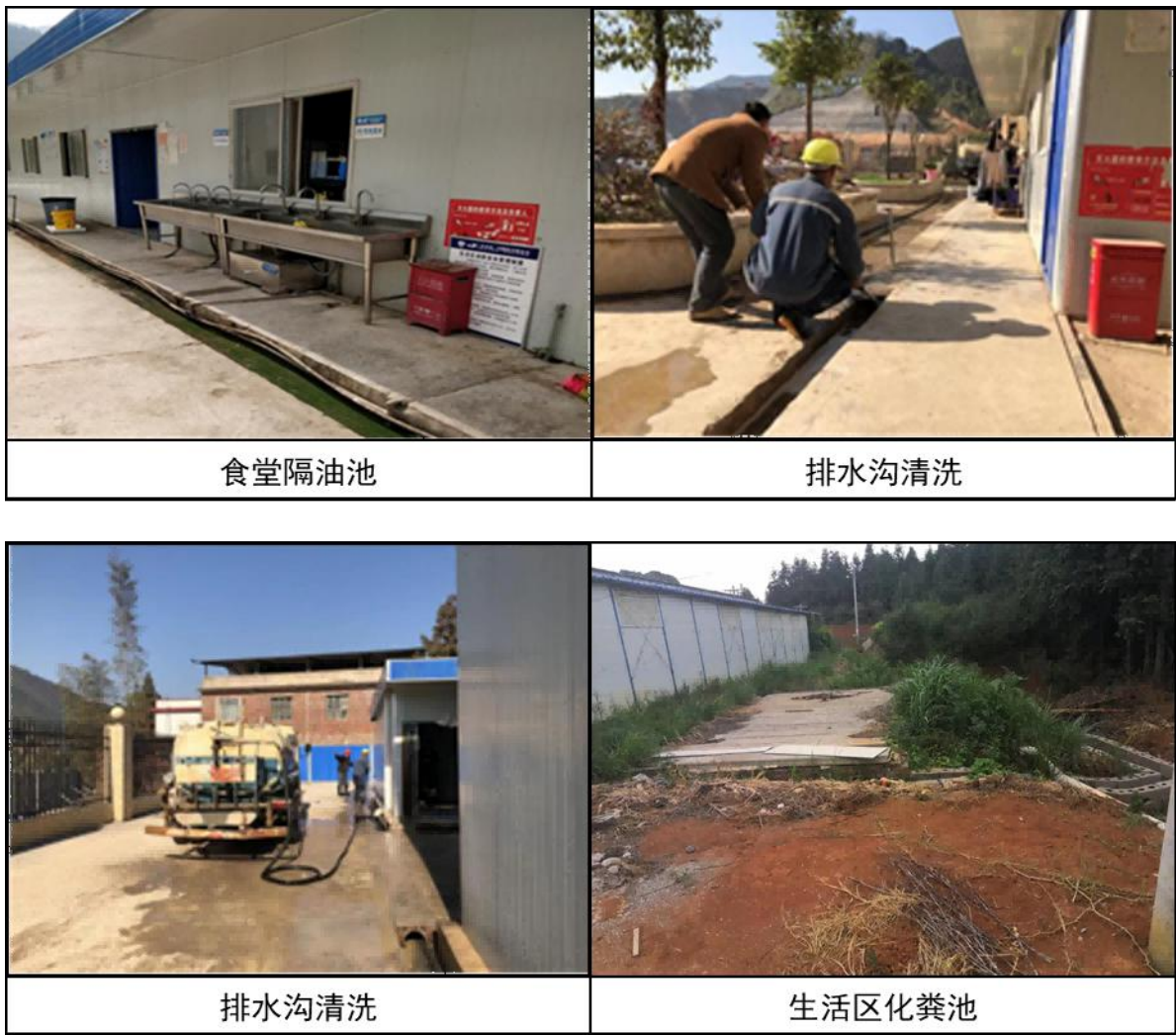
图 4.2-19 生活污水处理措施现场照片
